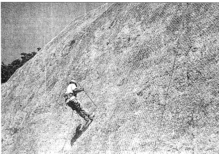
accident qui a coûté la vie à un homme de 40 ans, suite à la chute d'un rocher, a probablement accéléré le programme de sécurisation des lotissements comme ici au lotissement Hamuta.
